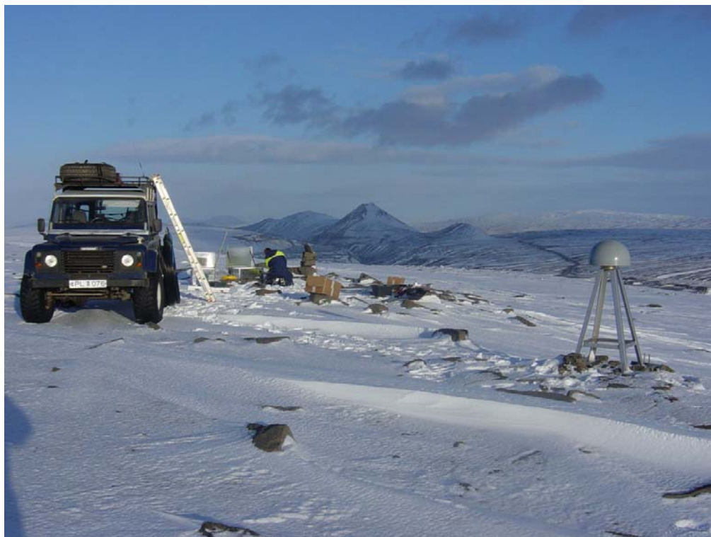
Mynd 6. Undirstaða og loftnetshlíf á SAUD, unnið að uppsetningu tækjabúnaðar á mastri fjær. Kárahnjúkar í baksýn.
