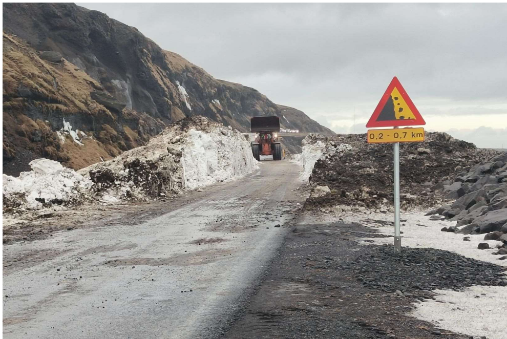
Mynd 18: Snjóflóðið í Ólafsvíkurenni þegar unnið var að mokstri í gegnum flóðatunguna. Ljósmynd: mbl.is/Alfons
